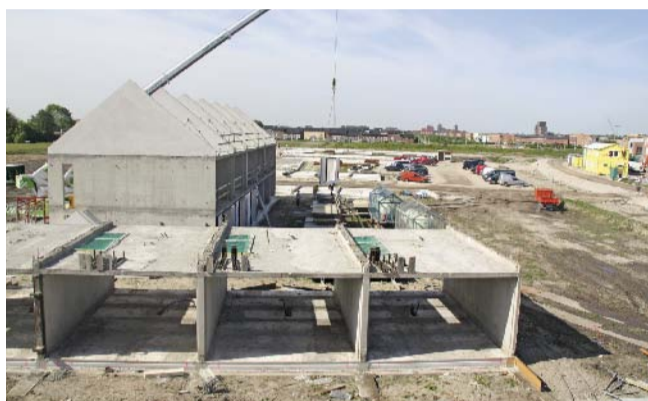
• Met gebruikte technieken, zoals speciale CO 2 -gestuurde ventilatiesystemen en warmtepompinstallaties met warmte-koudeopslag in de bodem, ligt de EPC op 0,42. Uit de begane grond komen de leidingen voor de warmte-koudeopslag.
